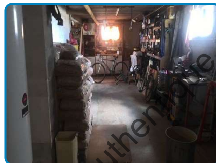
Maison principale Rez de chaussée Chaufferie
